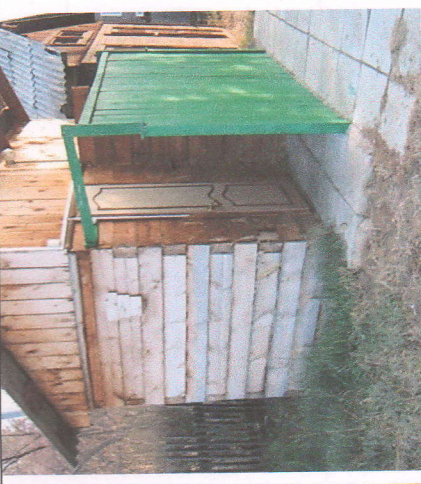
У дверей универсальной кабины уборной информационные указатели помещения отсутствуют
